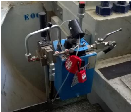
Consignación del sistema de bloqueo del tren de potencia, en el eje lento. Locking and tagging-out of the power train blocking on the slow shaft.
